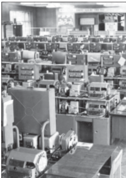
Общий вид зала аппаратуры кодовой коммуникации
