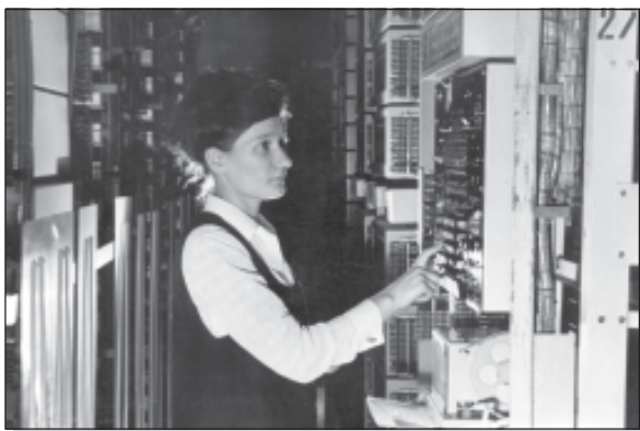
Автозал на Центральном телефонном узле
